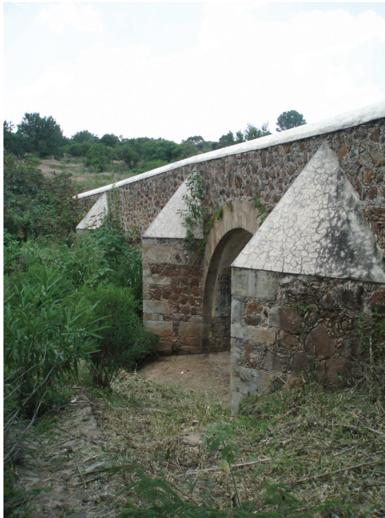
18. Fachada sur del puente de un arco en las lomas de Calderón. Fotografía de Carmen Vázquez Mantecón, agosto de 2009
